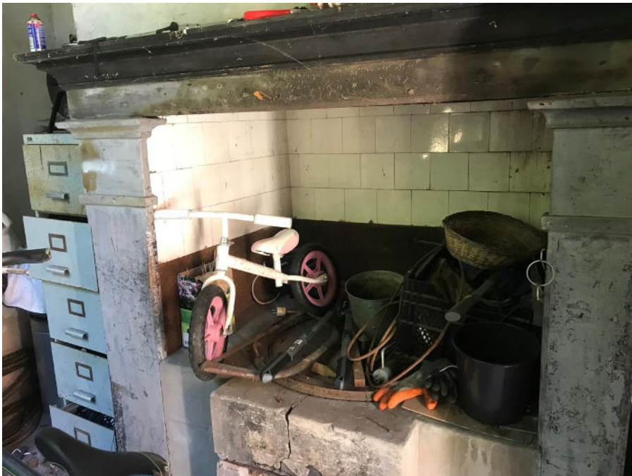
Figuur 44: Fornuis aan noordkant van het gebouw
